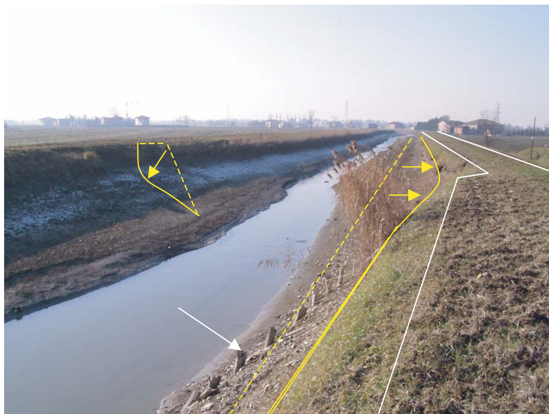
Fig. 13.22. Cavo Lama. Situazione prima dell'inizio dei lavori. A sinistra: con la linea tratteggiata è schematizzata l'originale sezione trapezoidale e con la linea continua lo stato attuale conseguente all'erosione. A destra: le linee gialle indicano il piede della scarpata spondale pre-erosione (in tratteggio) e attuale (linea continua). Le linee bianche indicano la sommità arginale; è evidente in secondo piano una sensibile riduzione della larghezza dell'argine, a seguito dell'erosione. (Foto: M. Monaci)
