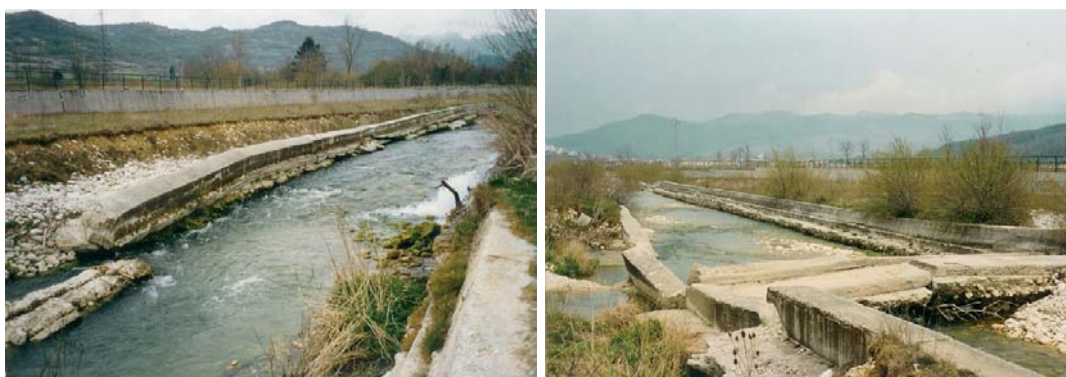
Fig. 11.6. Le opere di canalizzazione subiscono ingenti danni in seguito alla piena, in particolare vengono scalzate vaste porzioni delle difese spondali interne e distrutte numerose opere di fondo. (Foto: I. Schipani)
