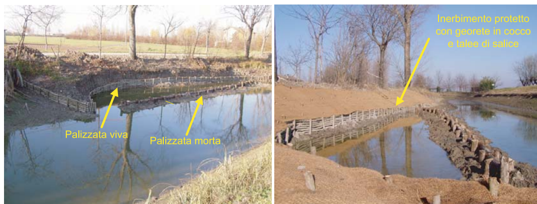
712 Fig. 13.16. Fasi intermedie dei lavori sul Canale di Migliarina (dicembre 2004): creazione dello stagno tramite escavazione e approfondimento del sito, realizzazione di palizzate vive a sostegno della sponda e palizzate morte tra il canale e lo stagno, copertura della sponda con inerbimento protetto da georete in cocco, fissata con talee di salice. (Foto: M. Monaci)
