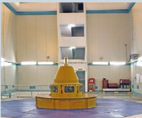
Turbines of HPP Doblar 2
