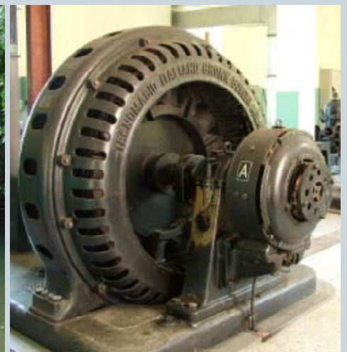
Turbines of HPP Gradišče
