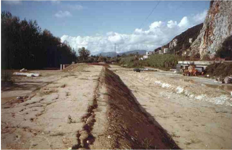
Foto 4 – Argine della cassa d'espansione subito dopo la copertura del manufatto in cls armato con terreno prelevato in loco.
