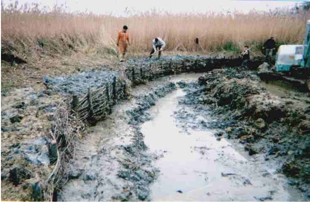
Foto 6 – Fase di cantiere di uno degli stagni realizzati all'interno della cassa di espansione del lago di Porta. Le sponde del lago sono state consolidate con fascinata doppia viva.
